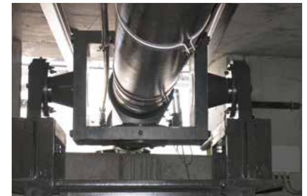
Elektromechanische aandrijving sluisdeuren Evergem
