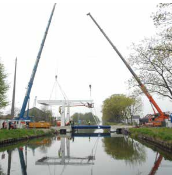
Elektromechanische & hydraulische uitrusting Brug 5 te Beerse (België)
