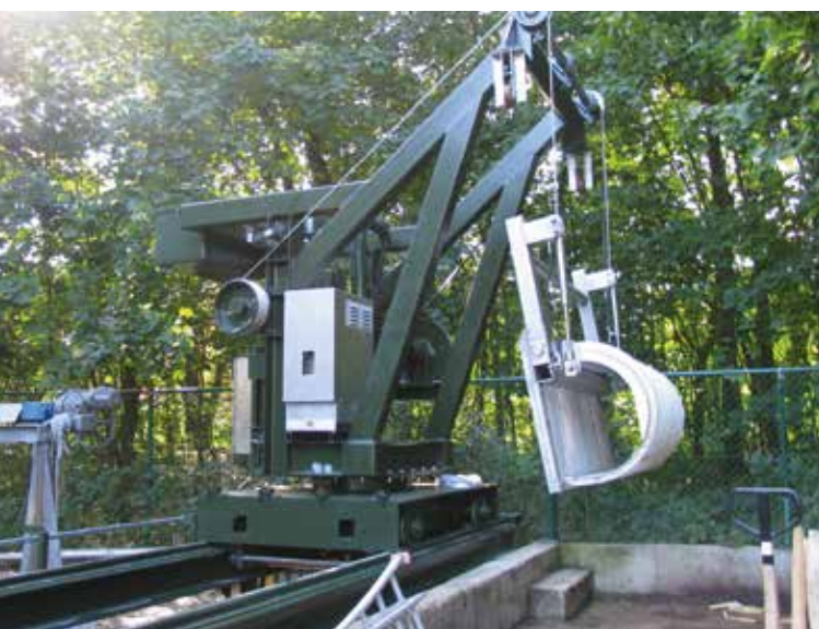
Roosterreiniger - kraan - kabels - Brugge (België)
