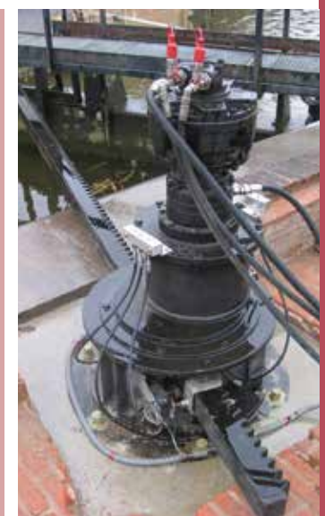
Elektromechanische aandrijving sluisdeuren Kanaal-Leuven-Dijle (België)
