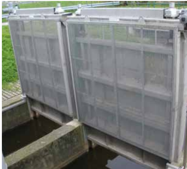
Staalbouw en elektromechanische uitrusting van de schuiven te Woumen Stenensluisvaart (België)
