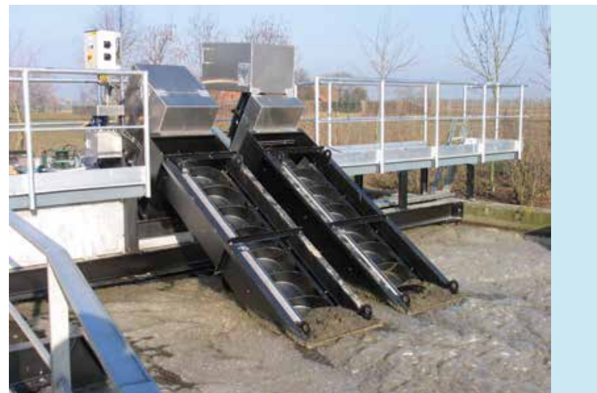
Prefab vijzelpompen te RWZI Poperinge (België)
