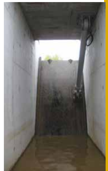
Staalbouw, Elektromechanische uitrusting en Hydraulica van de stuwen aan de Zandvoorbrug (België)
