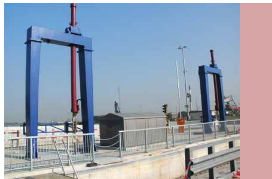
Elektromechanische aandrijving schuiven Vancauwelaertsluis (België)
