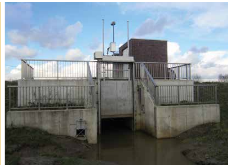
Staalbouw en elektromechanische uitrusting van de schuiven te Zandbergen (België)
