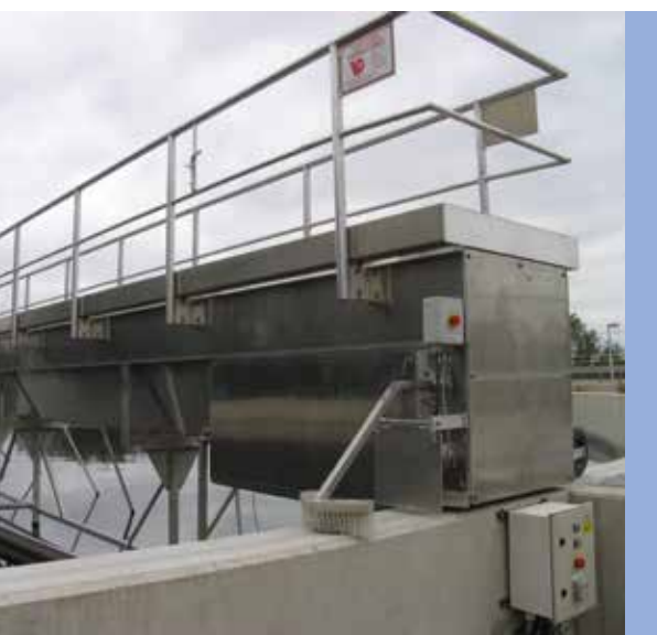
Diametrale ruimerbrug ALU kokerconstructie - diameter tank 42,5 m - RWZI Harelbeke (België)
