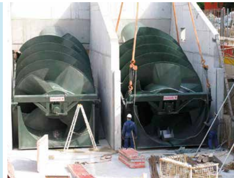
Waterkrachtvijzels met stalen stortgoot te Kocherwehr Hofratsmühle in Künzelsau (Duitsland) - 2 vijzels - 132 kW - 8,95 m³/s - Vijzeldiameter 4,1 m - Beschoepingslengte 4,8 m
