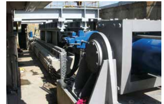
Elektromechanische uitrusting klepdeuren sluiscomplexen op het Albertkanaal (België)
