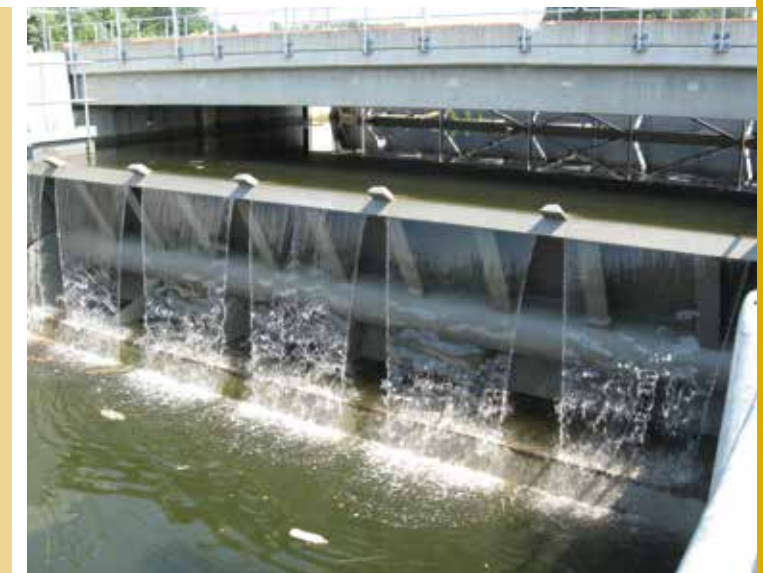
Staalbouw + Elektromechanische uitrusting van de stuwen op het sluisencomplex te Asper (België)
