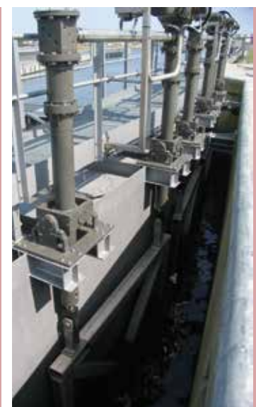
Elektromechanische aandrijving deurschuiven Evergem (België)
